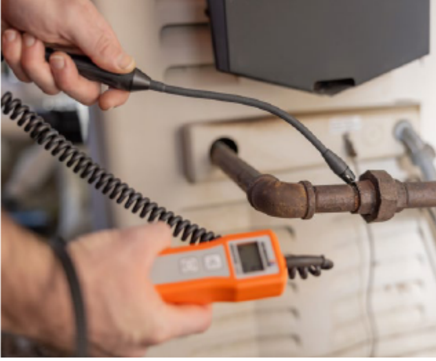
Gazlı havuz ısıtma sisteminin incelenmesi
